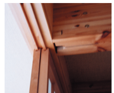
建具の動きにも支障がないことから、構造体のゆがみも無いと思われる。
